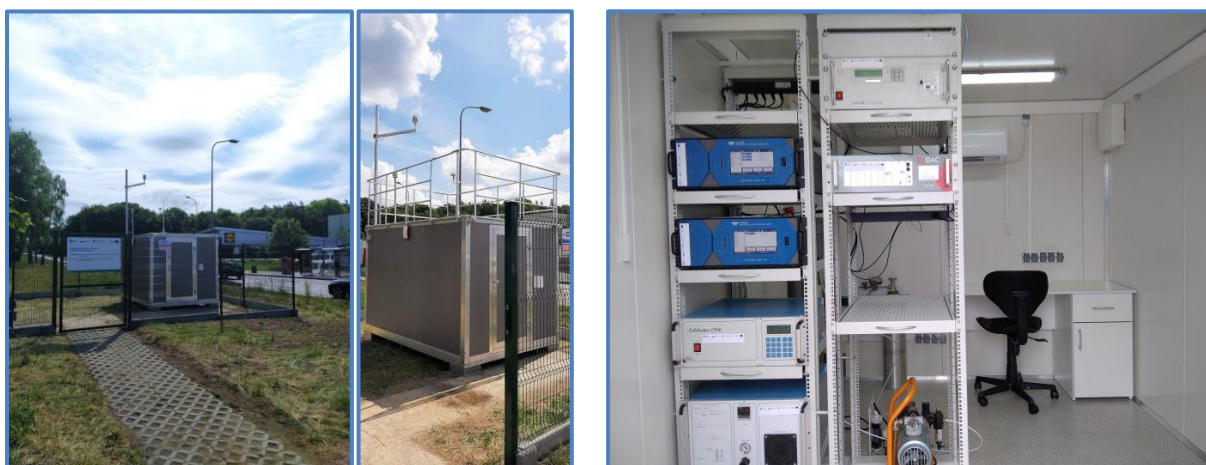
Ryc.35 Zdjęcia nowej stacji AM7 w Gdańsku.
